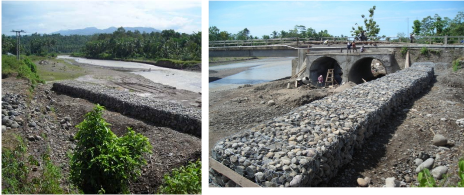
Foto 3. Foto kenampakan way Ngarip yang sering menimbulkan banjir pada saat musim penghujan, perhatikan hasil gerusan/erosi sungai menyebabkan jembatan diperbaiki
