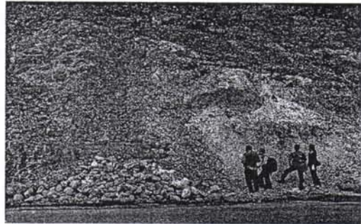
Foto 7. Breksi vulkanik teralterasi (propilitisasi, silisifikasi, argilitisasi, oksidasi). Luas = 100 m x 50 m. Terjadi longsoran, di tepi jalan Bengkulu – Kepahyang, 2007.
