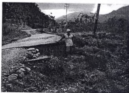
Gambar 3 : Foto memperlihatkan badan jalan yang longsor di daerah Plumbungan, Banjarnegara, Jawa Tengah.
